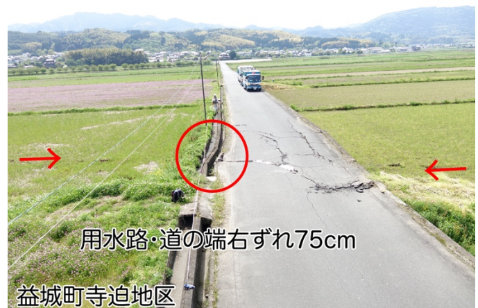
写真2 益城町寺迫地区の地表地震断層
